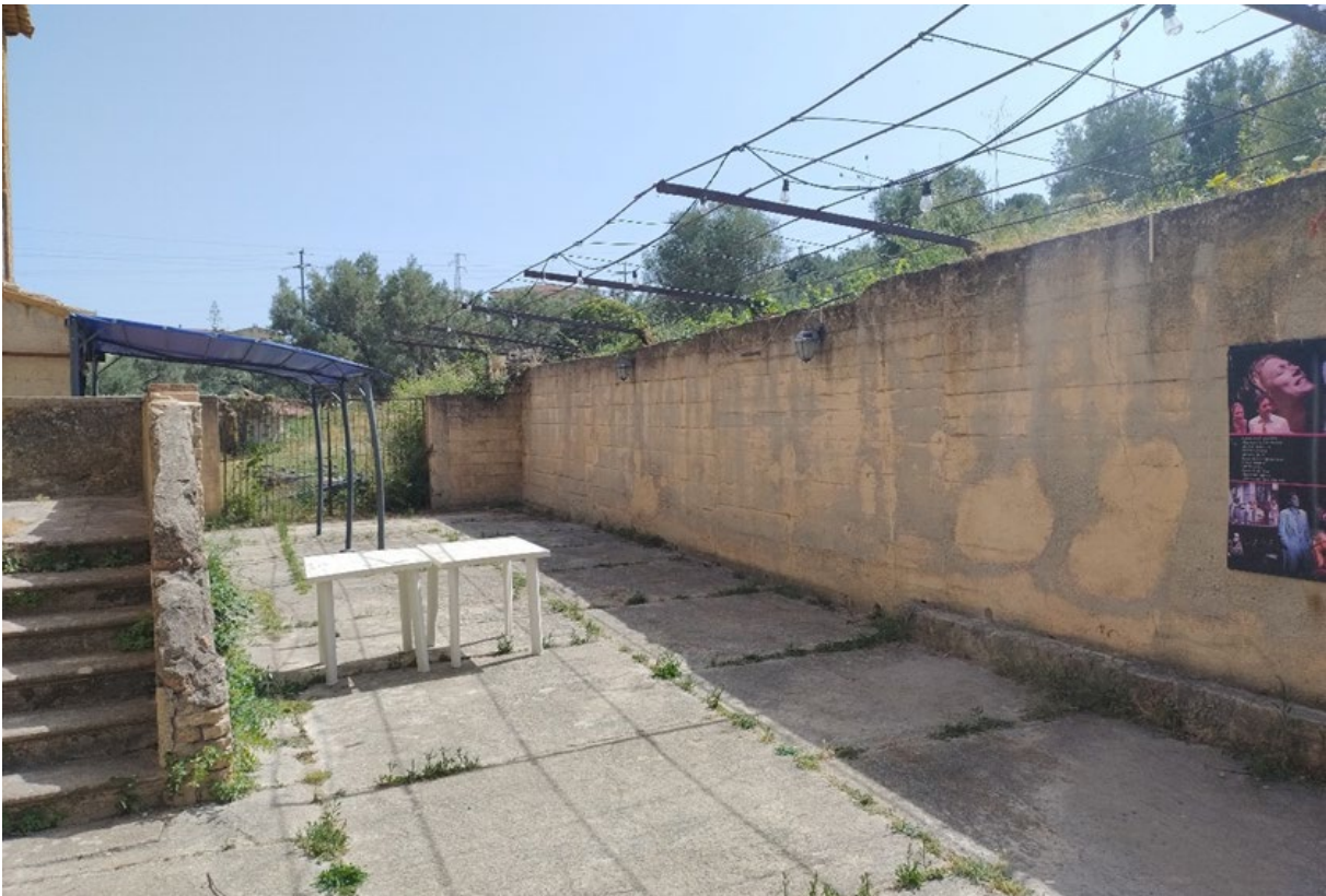
Foto 15. Muro di contenimento in c.a. fra il primo terrazzamento dell'ex vigna e il piano di campagna del vecchio borgo
