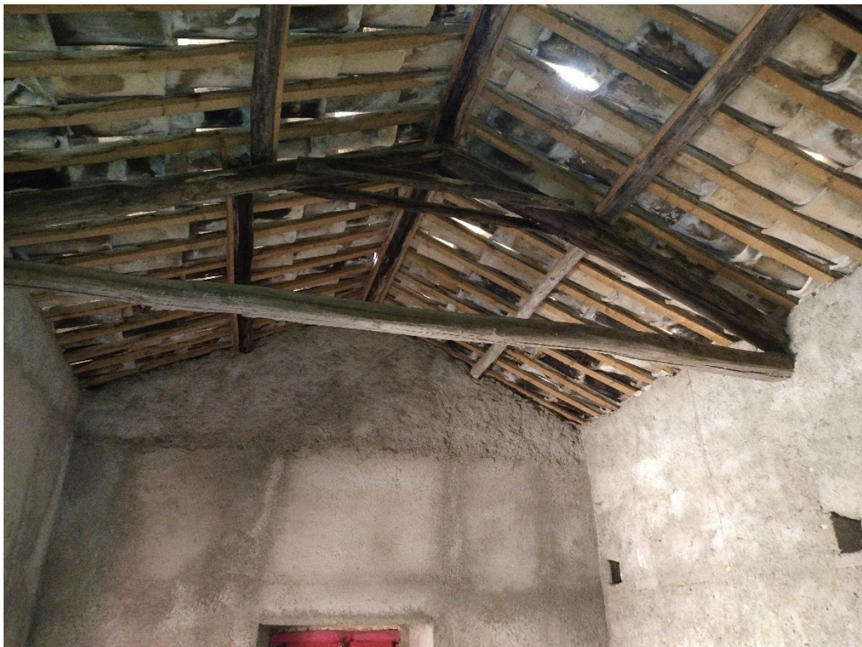
Foto 32. Particolare della copertura a coppi e canali su struttura portante in legno
